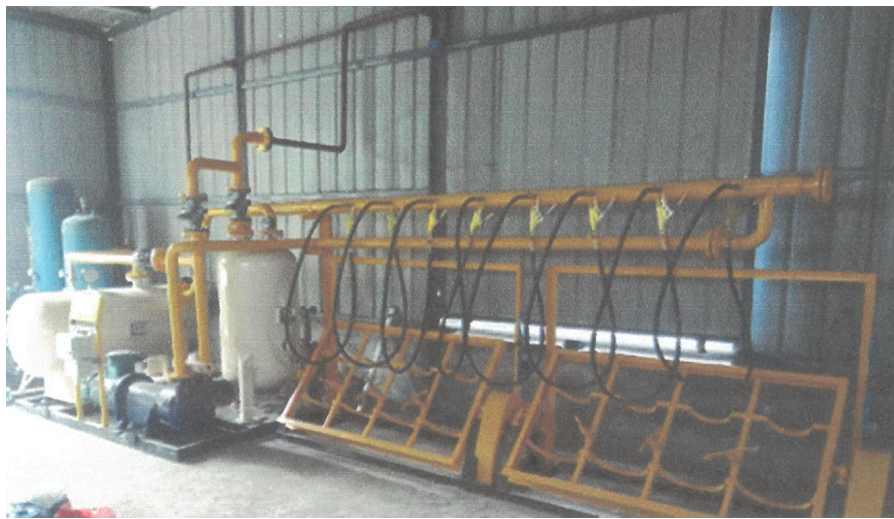
图 2-4 项目液化气钢瓶残液回收装置实物图
