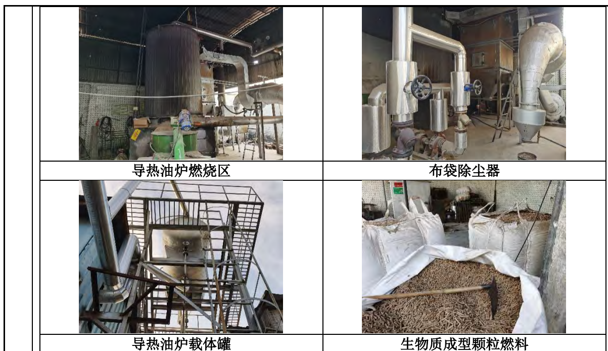
图 2.13-3 现有项目导热油炉废气收集/处理设备现状图
