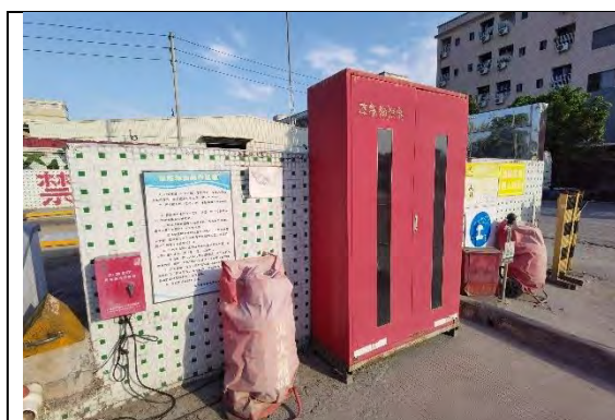
储罐区消防措施
